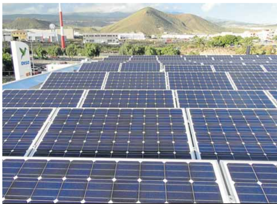
PANELES SOLARES ubicados en la cubierta de una de las gasolineras de la empresa DISA.
